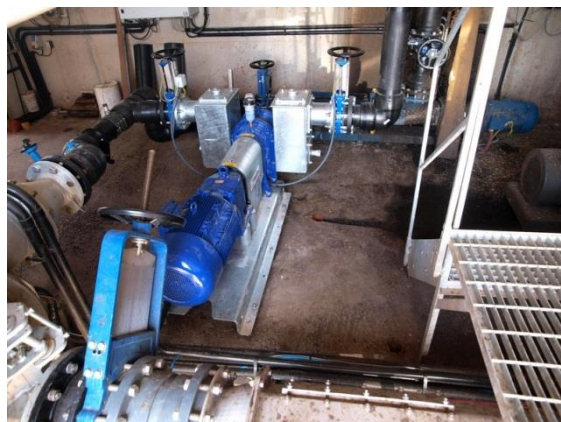
Obr. 35: namontované čerpadlo s rotujícími písty
